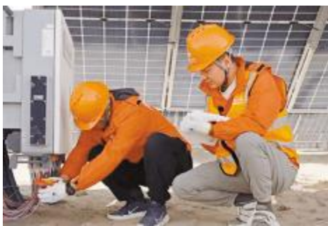
通威售后巡检服务团队开展电站巡检
