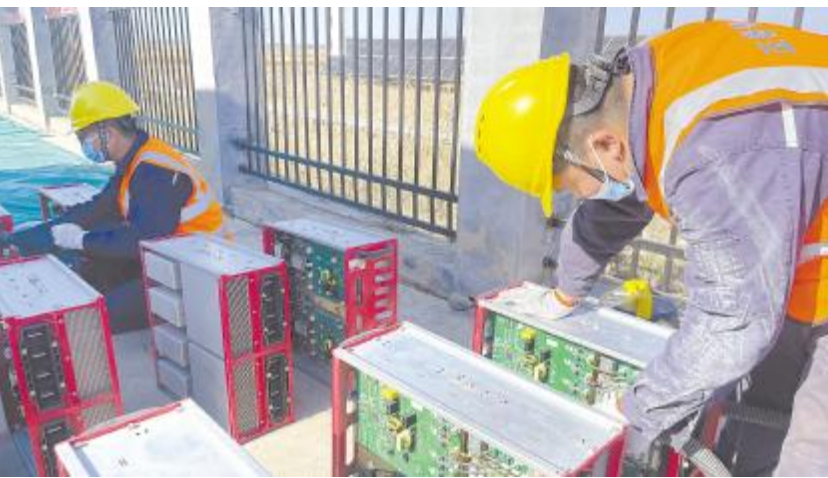
通威乾安“渔光一体”电站运维人员维护设备
