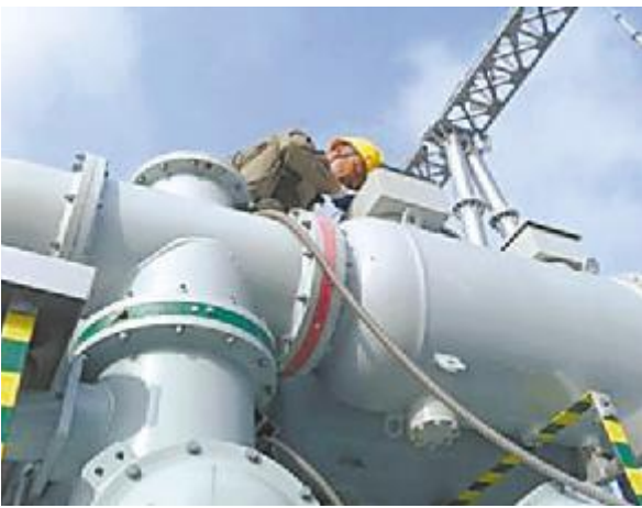
巡检设备,保障电站安全运行
